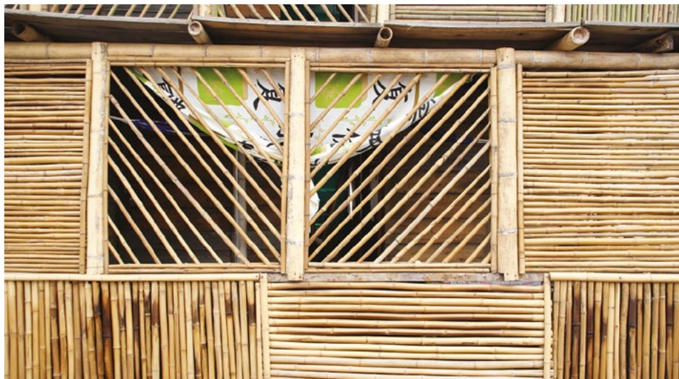
Figure 15. La versatilità della guadua nelle finiture esterne dell'asentamiento Fonte: Valentina D'Ippolito e Bianca Galmarini, 2017.
