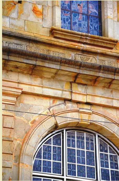
Mecanismo de colapso por desplazamientos de las dovelas de los arcos Fuente: Michele Paradiso, 2017.
