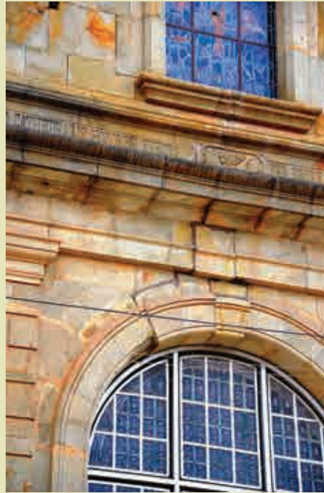
Mecanismo de colapso por desplazamientos de las dovelas de los arcos Fonte: Michele Paradiso, 2017.
