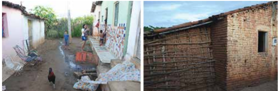
Figura 3. À esquerda, esgoto lançado na rua com a passagem de pessoas e animais, e à direita, exemplo de edificações com alvenaria autoportante e pau-à-pique, com o uso de materiais e técnicas regionais Fonte: Francisco Gustavo C. de L. Moura, 2016.
