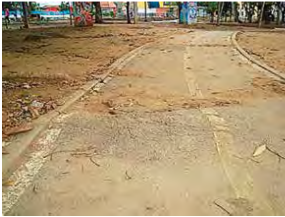
Figura 2. Deterioro de la cicloruta. Fuente: Leonardo Enrique Díaz Suárez, 2015.
