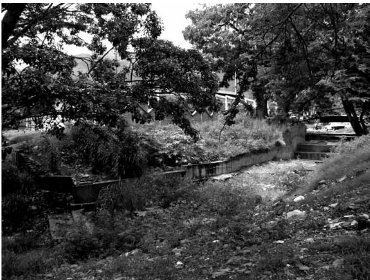
Foto 2. Deterioro de la desembocadura de la Quebrada las Nieves de Girón con el Río de Oro
