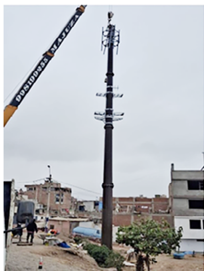
a) Infraestructura pasiva
