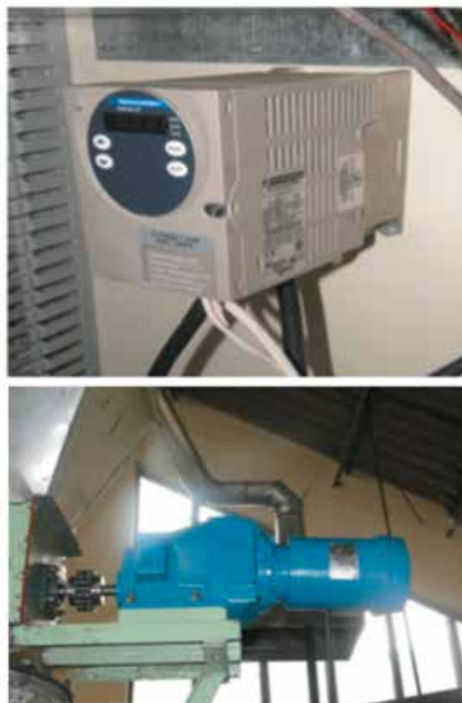
Fig. 10. VARIADOR - MOTOR TRIFÁSICO ACOPLADO DEL TORNILLO SINFIN
