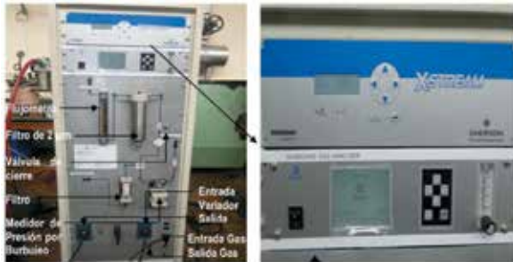
Fig. 6. SISTEMA DE ANALIZADORES DE GASES
