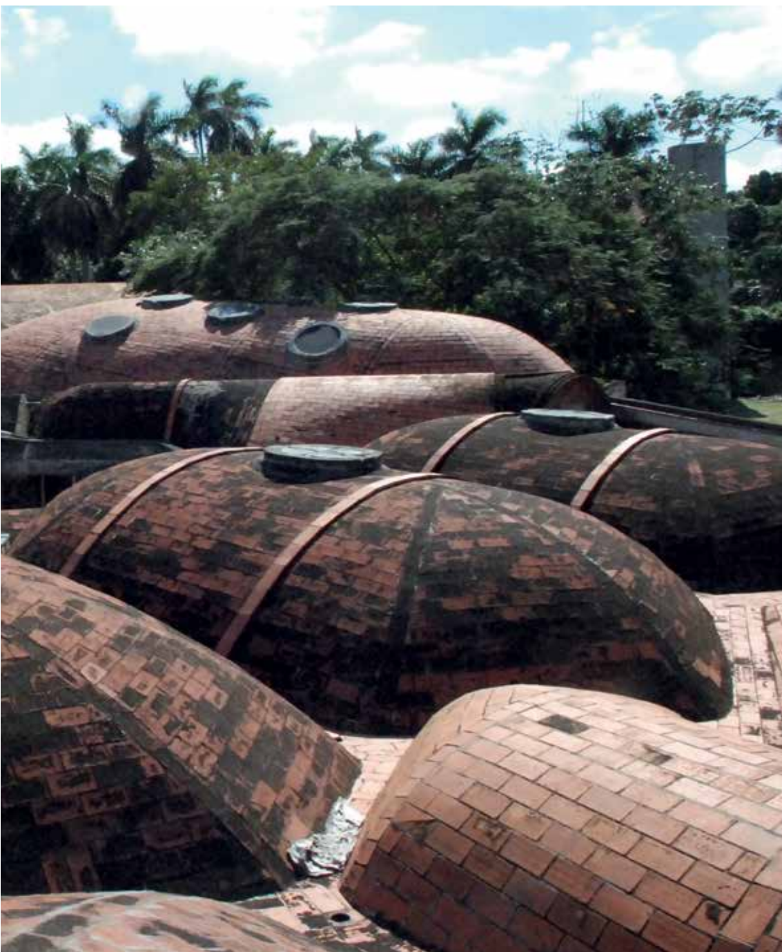
Figura 9. Particolare delle volte catalana in avanzato stato di degrado alla Scuola d'Arti Sceniche. Fonte: Arch. Michele Paradiso.
